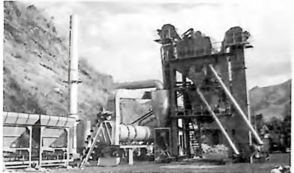
Trạm trộn bê tông nhựa công suất 40 tấn/giờ
